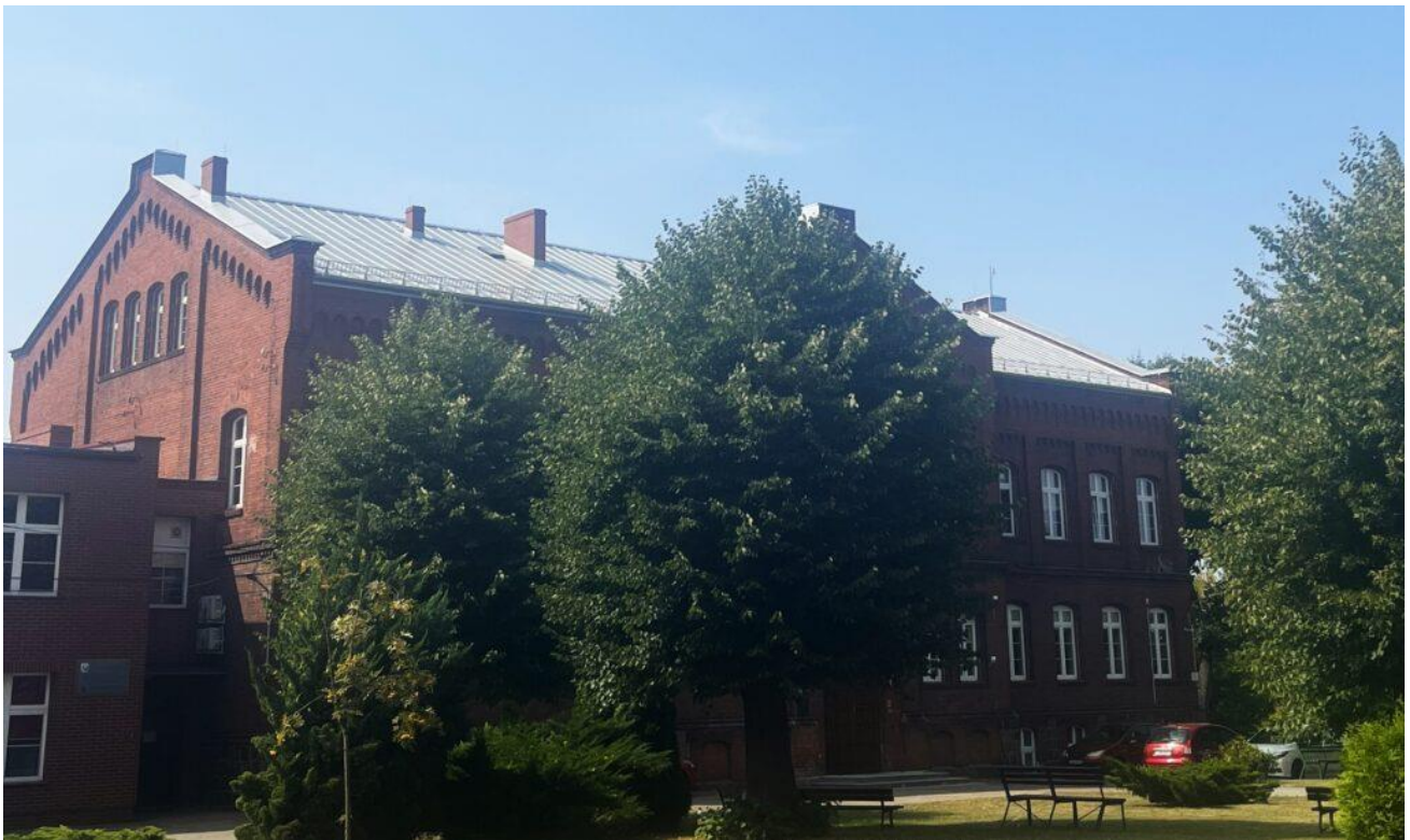
Zdj. Pokrycie dachowe na budynku I LO w Świeciu
